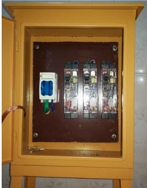
1. 2. 10-2 照明开关箱实物图
