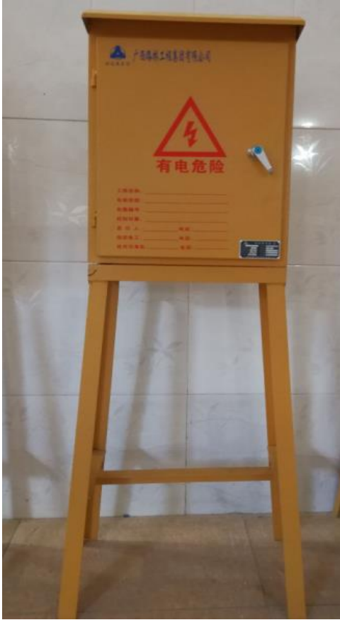
1.2.9-1 动力开关箱实物图
