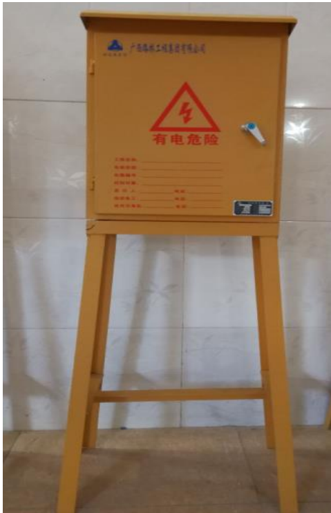
1. 2. 11-1 电焊机专用开关箱实物图
