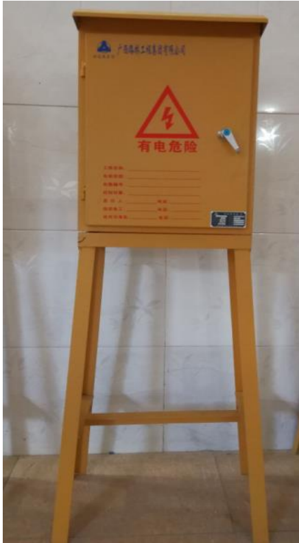
1. 2. 10-1 照明开关箱实物图
