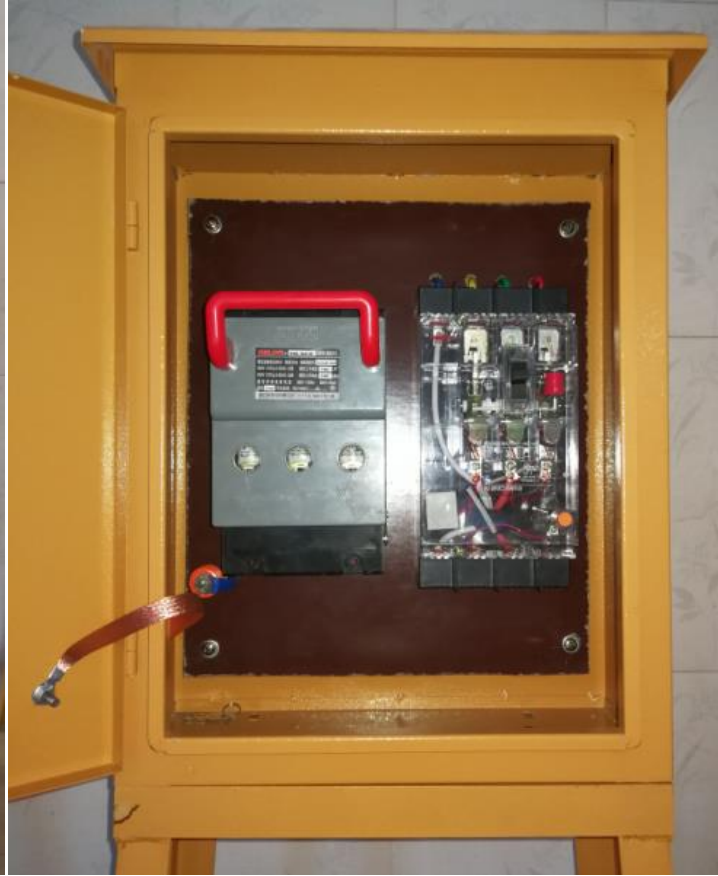
1.2.9-2 动力开关箱实物图
